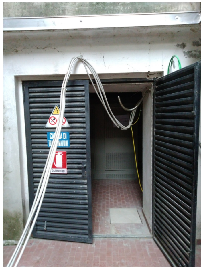
PORTA ACCESSO CABINA
